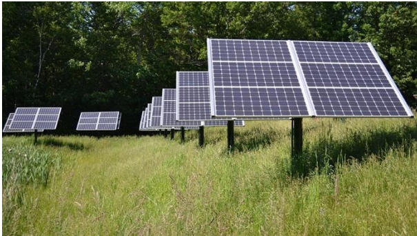
PV-Anlage Bildquelle: AdobeStock
